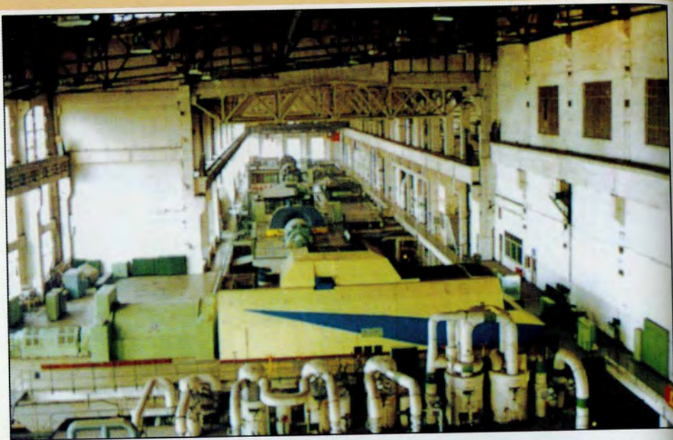
南京热电厂气机主厂房
