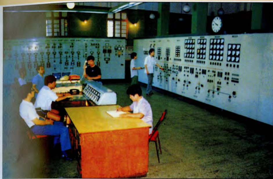
下关发电厂于50年代建成的新厂电气控制室
