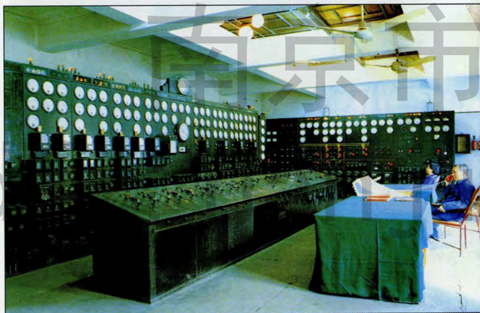
首都电厂下关发电所30年代中期建成的老厂电气控制室
